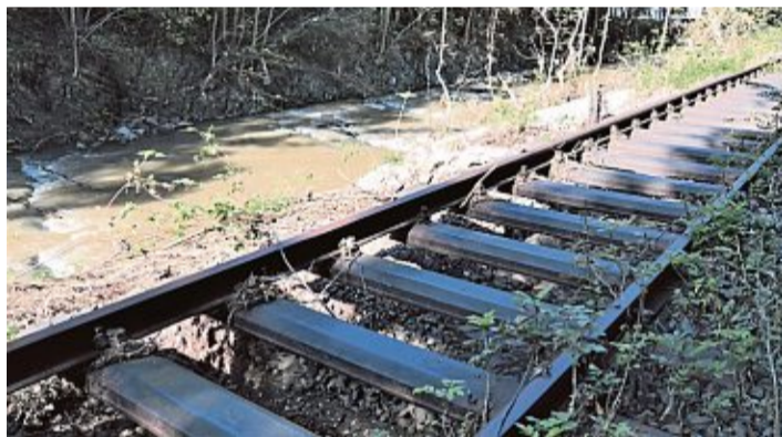
Die Schienen hängen in der Luft: Zwischen Olef und Schleiden wurde die Strecke unterspült und die Stützmauer weggeschwemmt.
