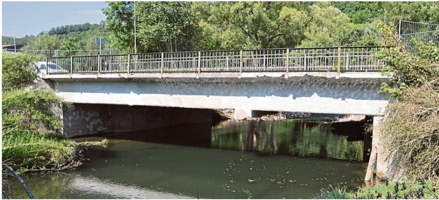
Die Urftbrücke am Ortseingang von Gemünd-Mauel ist einsturzgefährdet. Der Mittelpfeiler wurde weggerissen.
