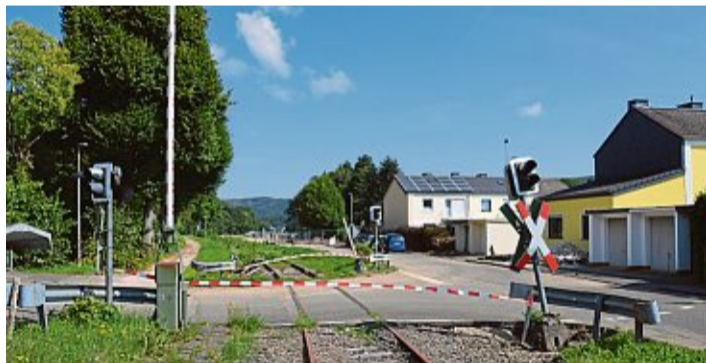
Der Bahnübergang am Johannesweg in Olef ist einer von zahlreichen Übergängen, die von den Wassermassen zerstört wurden.
